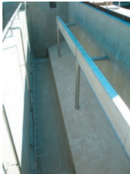
Betónová konštrukcia lapača piesku a tuku s technologickými rozvodmi.
