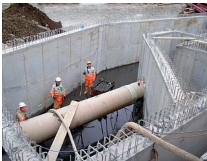
Sústava na likvidáciu odpadových vôd – Banská Bystrica
